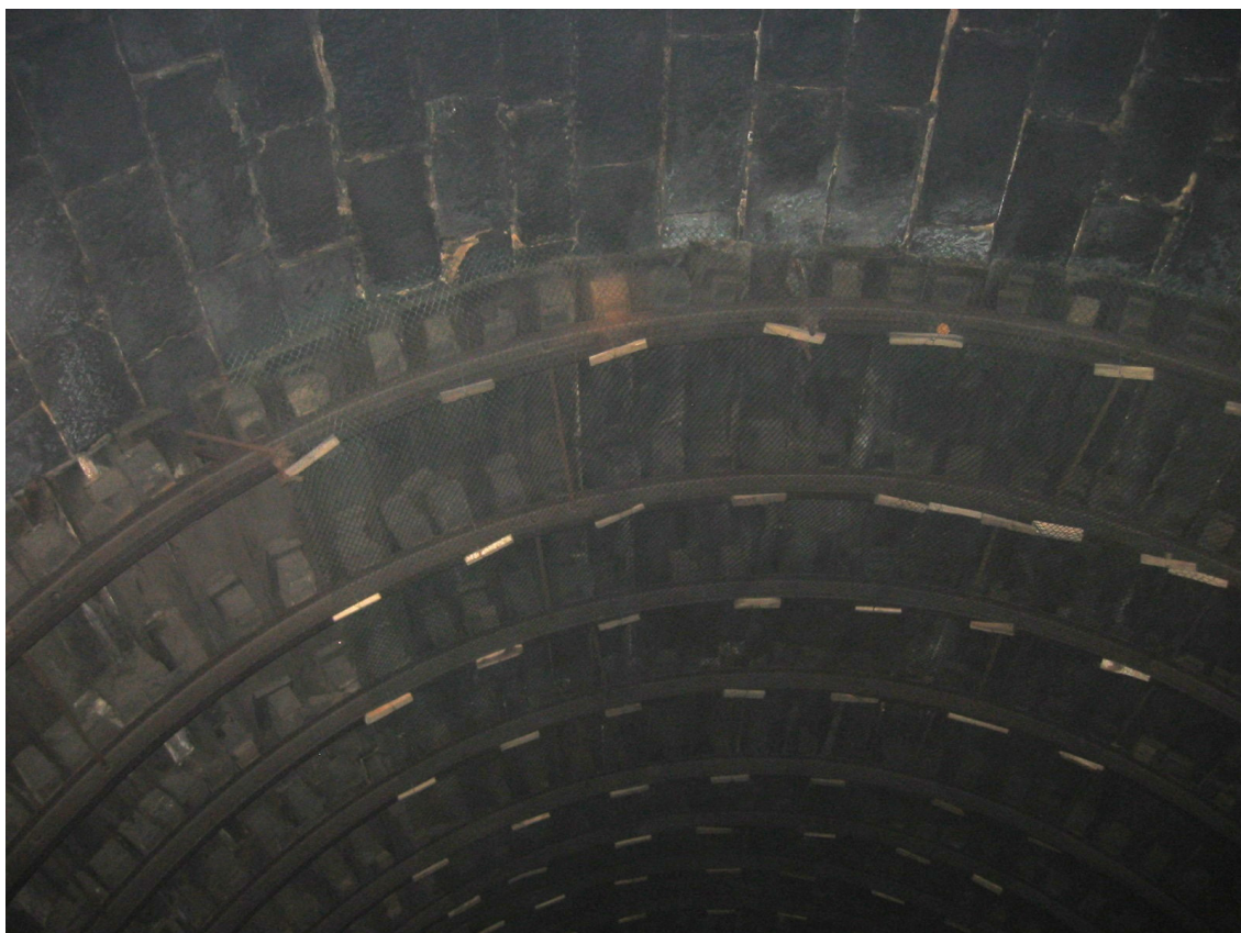
Obr. 1 Stav tunelu před sanací – podsružení
