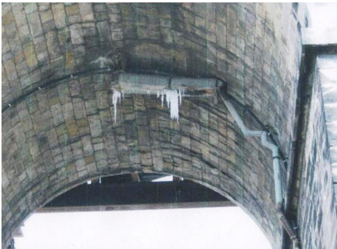
Obr. 7 Stav odvodnění mostu před rekonstrukcí
