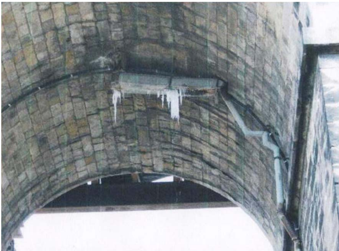
Obr. 7 Stav odvodnění mostu před rekonstrukcí
