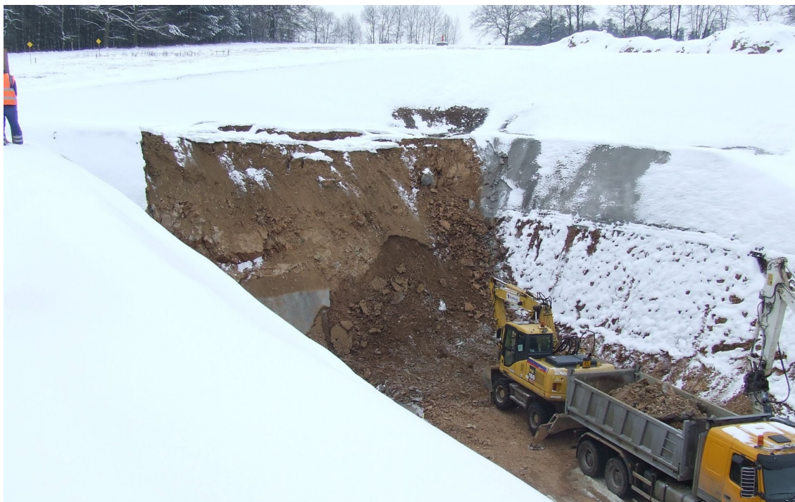
Obr. 2 Sesuv čelní portálové stěny
