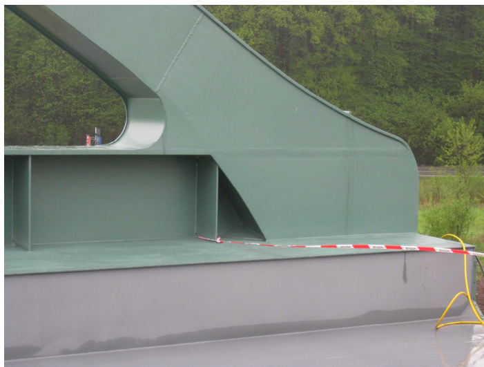
Obr. 5 Napojení oblouku na trám
