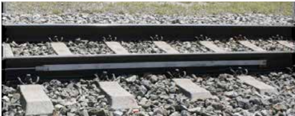
Obr. 5 Lišta s řetízkem FBG senzorů instalovaná na kolejovém svršku
