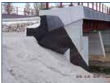
Obr. 7 Částečně zasypané křídlo opěry
