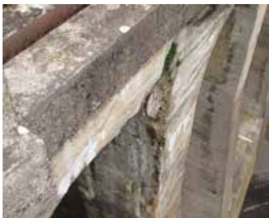
Obr. 2 – degradace betonu konzoly NK v místě uložení vloženého pole - stav před rekonstrukcí
