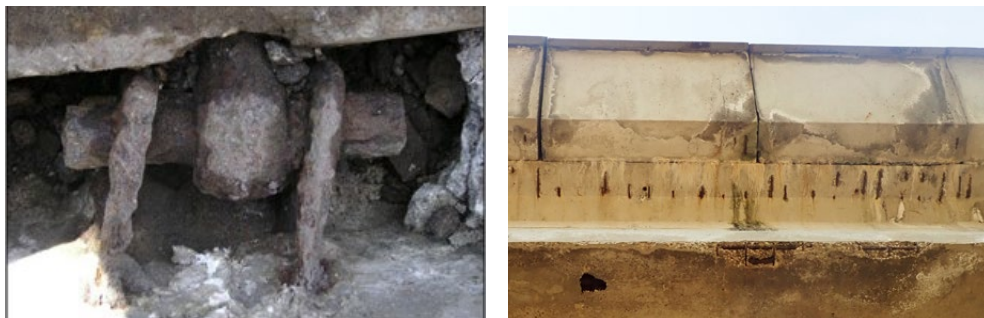
Obr. 8 – Detail kotev prefabrikovaných konzol poškozených korozí a detail protékání vody z kolejového lože skrz spáry segmentů prefabrikovaných konzol
