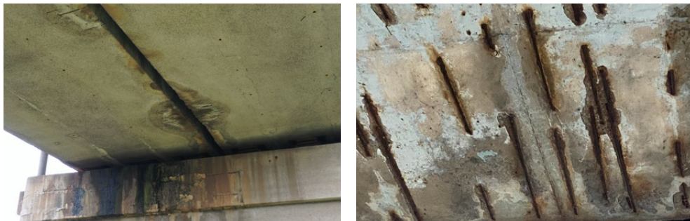
Obr. 6 – Vlevo: zatékání v místech odvodnění kolejového lože mezi 2 nepropojené hlavní nosníky a u dilatace na úložné prahy, vpravo detail koroze betonářské výztuže s malým krytím včetně odpadávání krycí vrstvy
