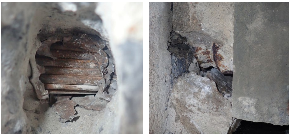
Obr. 9 – Vlevo destruktivní sonda k předpínací výztuže s nezainjektovaným kabelovým kanálem, vpravo obnažené kotvy předpínací výztuže napadené korozí, kotvy se nachází v oblasti dilatace
