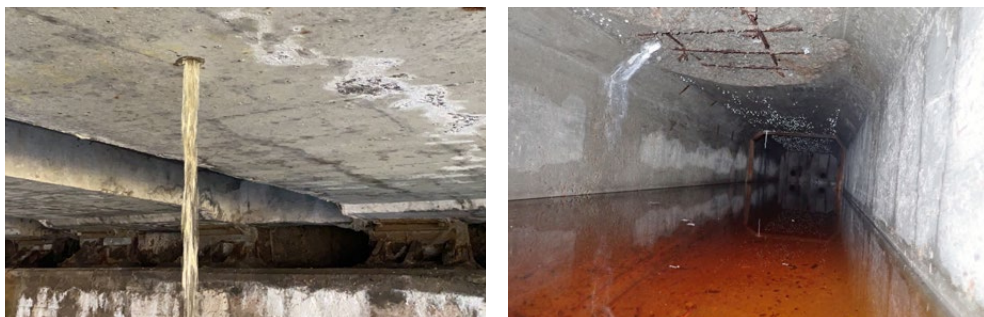
Obr. 7 – Akumulace vody v dutinách – vlevo foto vytékající vody po navrtání otvoru do dutiny nosníku, vpravo dutina nosníku z části zaplněná vodou s odpadlou krycí vrstvou betonu z horní příruby
