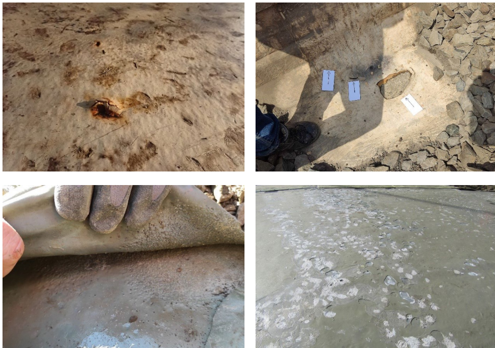
Obr. 1 až 4 – Příkladů poškození vodotěsné izolace na různých typech povrchů
