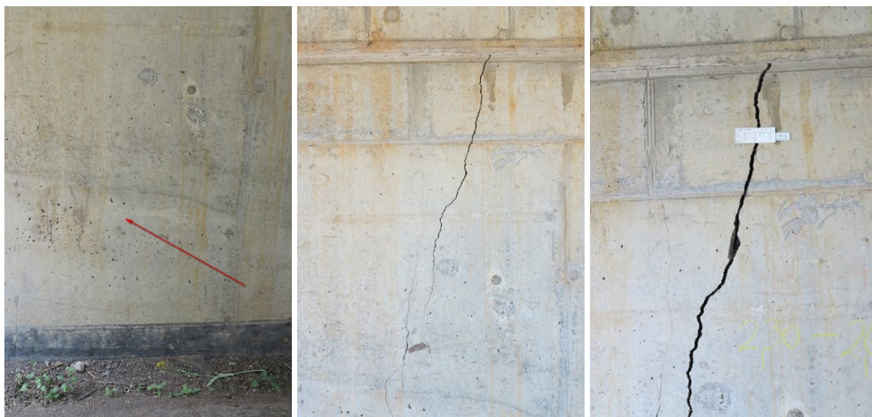
Obr. 2 – Rozvoj trhliny v opěře v letech 2016, 2019, 2022
