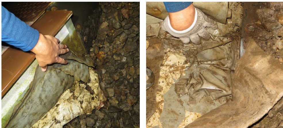
Obr. 6 a 7 – Sonda 1 – dělení izolace na jednotlivé vrstvy, řasení nepřilnavost k podkladu
