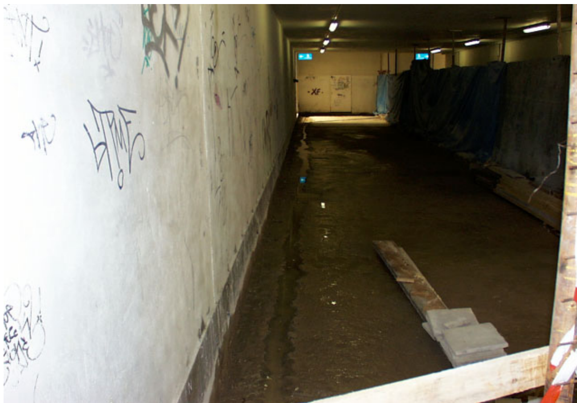
obrázek č.1 podchod v Hodoníně (TÚ: 2401, km:104,259)
